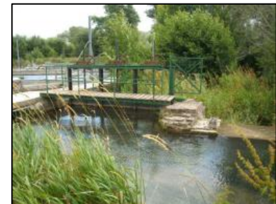
Figure 54 : vannage adjacent à la pisciculture de Famechon
